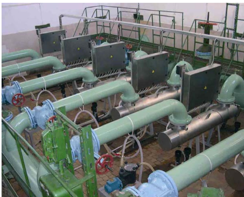
Водопроводно-насосная станция №2, г. Новокуйбышевск
