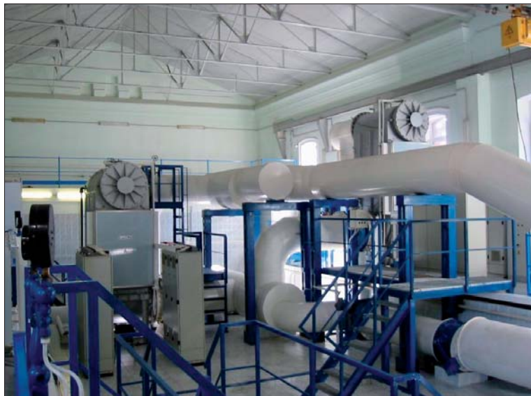
Рис. 7. УФ-блок на Главной водопроводной станции
