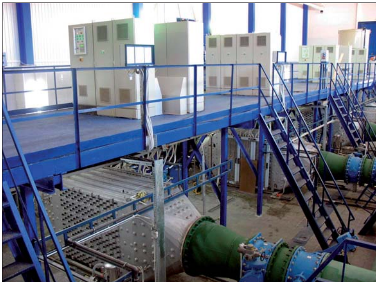
Рис. 10. Московская повывисительная подстанция
