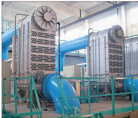
Рис. 6. Станция УФ-обеззараживания на Северном ковшовом водозаборе в г. Уфе
