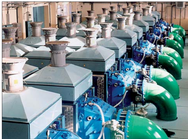
Рис. 3. Станция УФ-обеззараживания сточных вод в г. Тольятти
