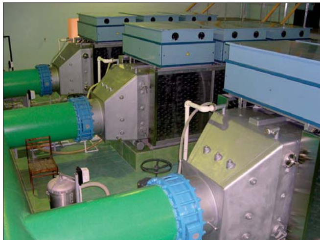
Рис. 5. Станция УФ-обеззараживания сточных вод в г. Сарапале
